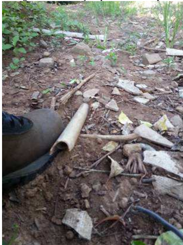
Figura 16: Tubulação quebrada e entupida
